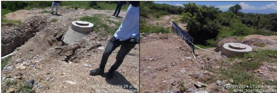
Se evidencia presencia que de las escorrentias de agua superficial generando daño al terreno natural en el entorno de la estructura hidráulica.
